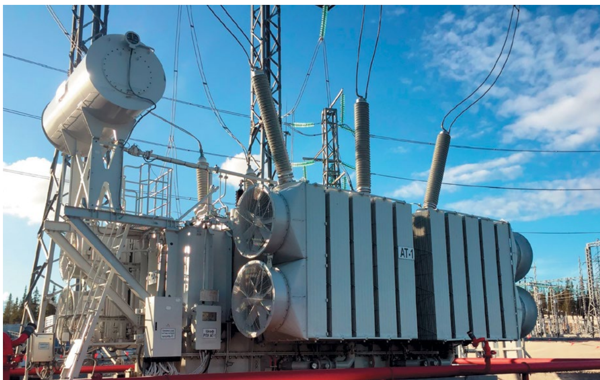
ПС 330 кВ «Мурманская», г. Мурманск, АДЦТН-250 000/330/150 УХЛ1
