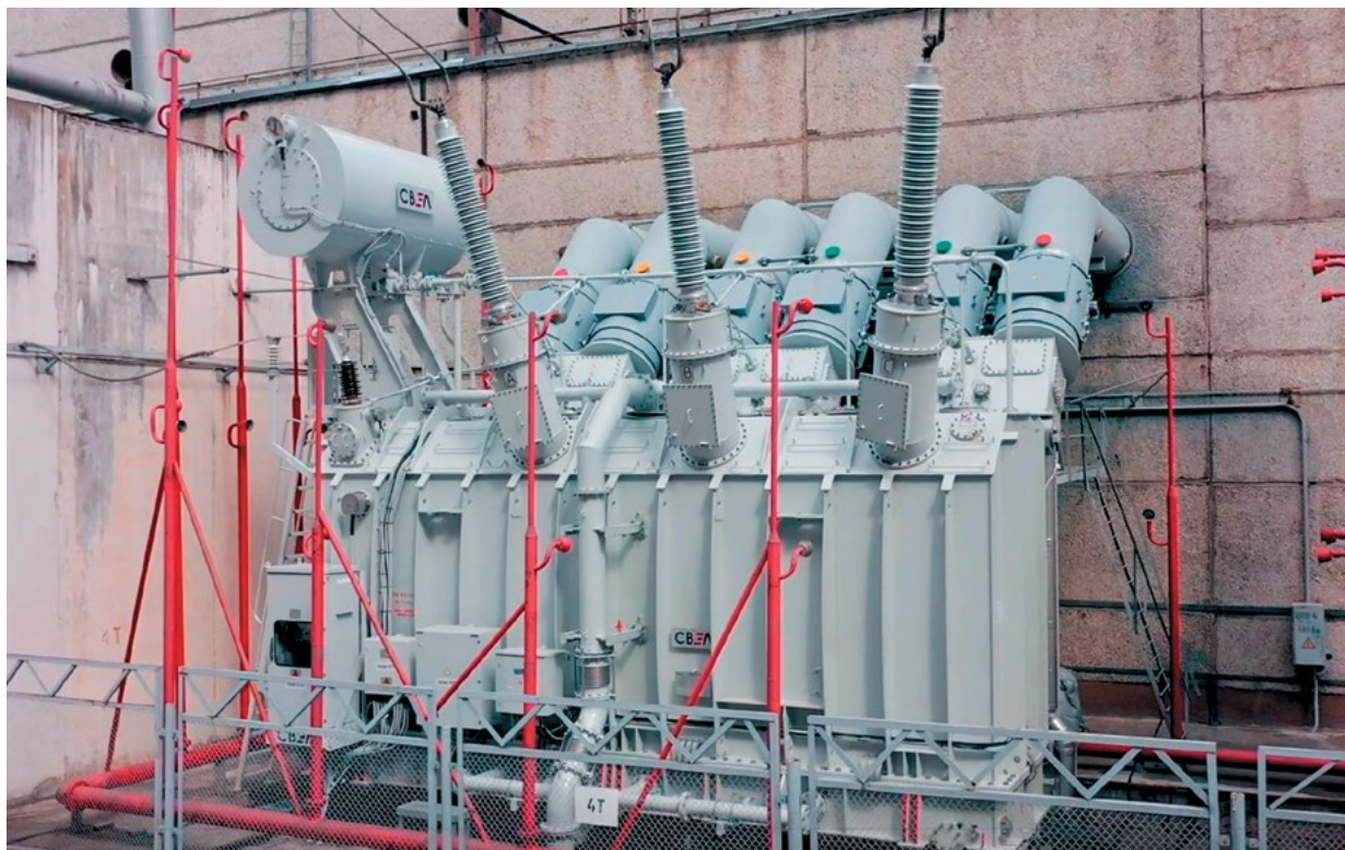
Красноярская ГЭС, г. Дивногорск, ТЦ-630 000/220 ВМ УХЛ1
