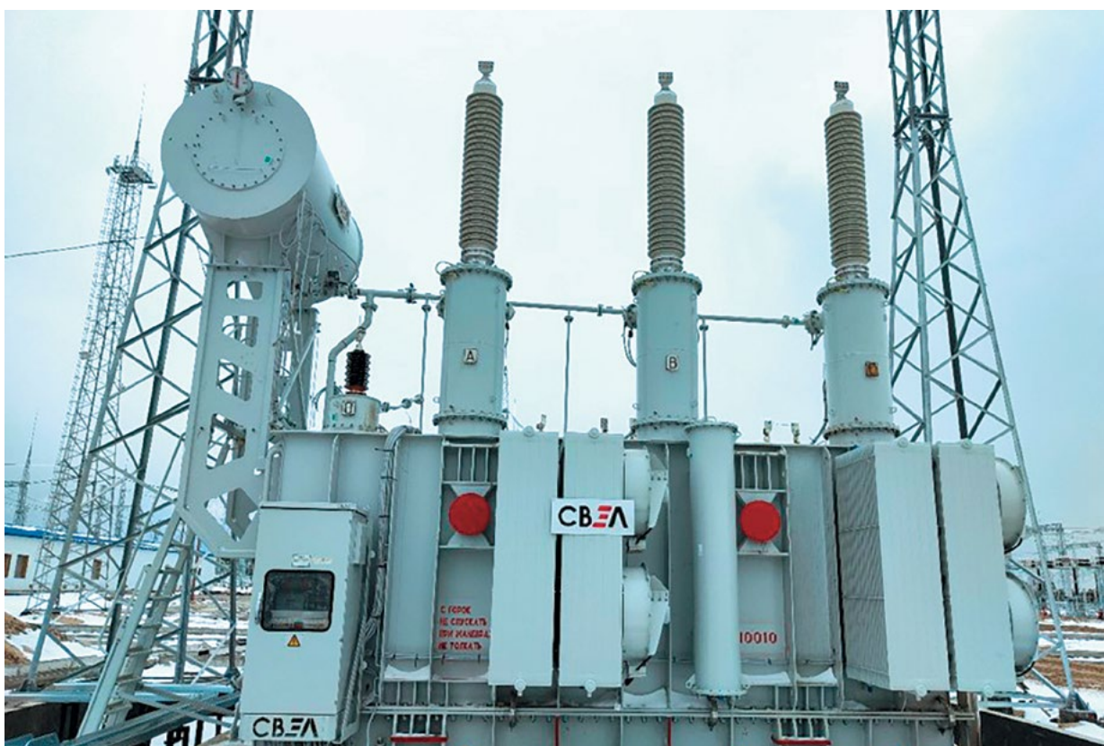
ПС 500 кВ «Нижнеангарская», респ. Бурятия, РКТРВД-50 000/220 ВМ ХЛ1
