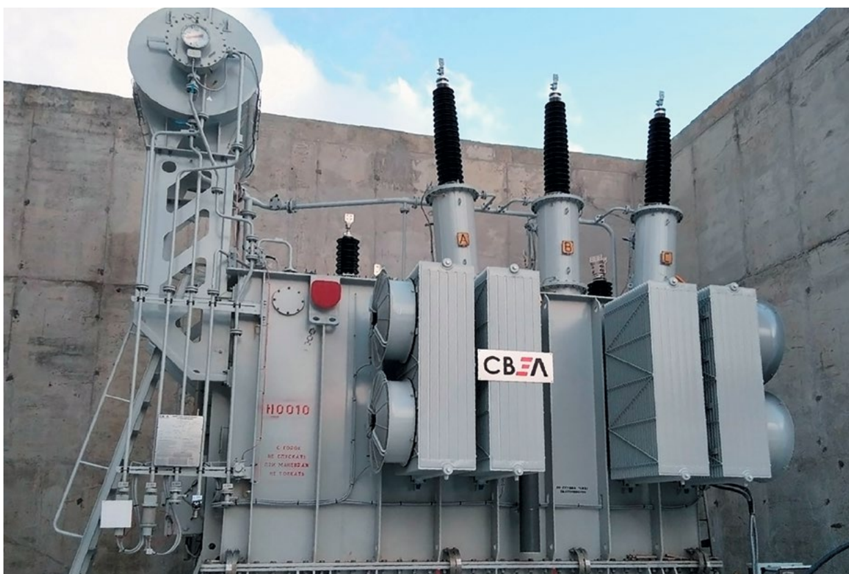
ПС 110 кВ «Северово», г. Подольск, ТДН-63 000/110 У1
