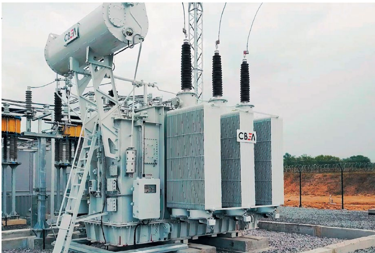
ПС 110 кВ «Гринхаус», Белгородская область, ТРДН-63 000/110 УХЛ1
