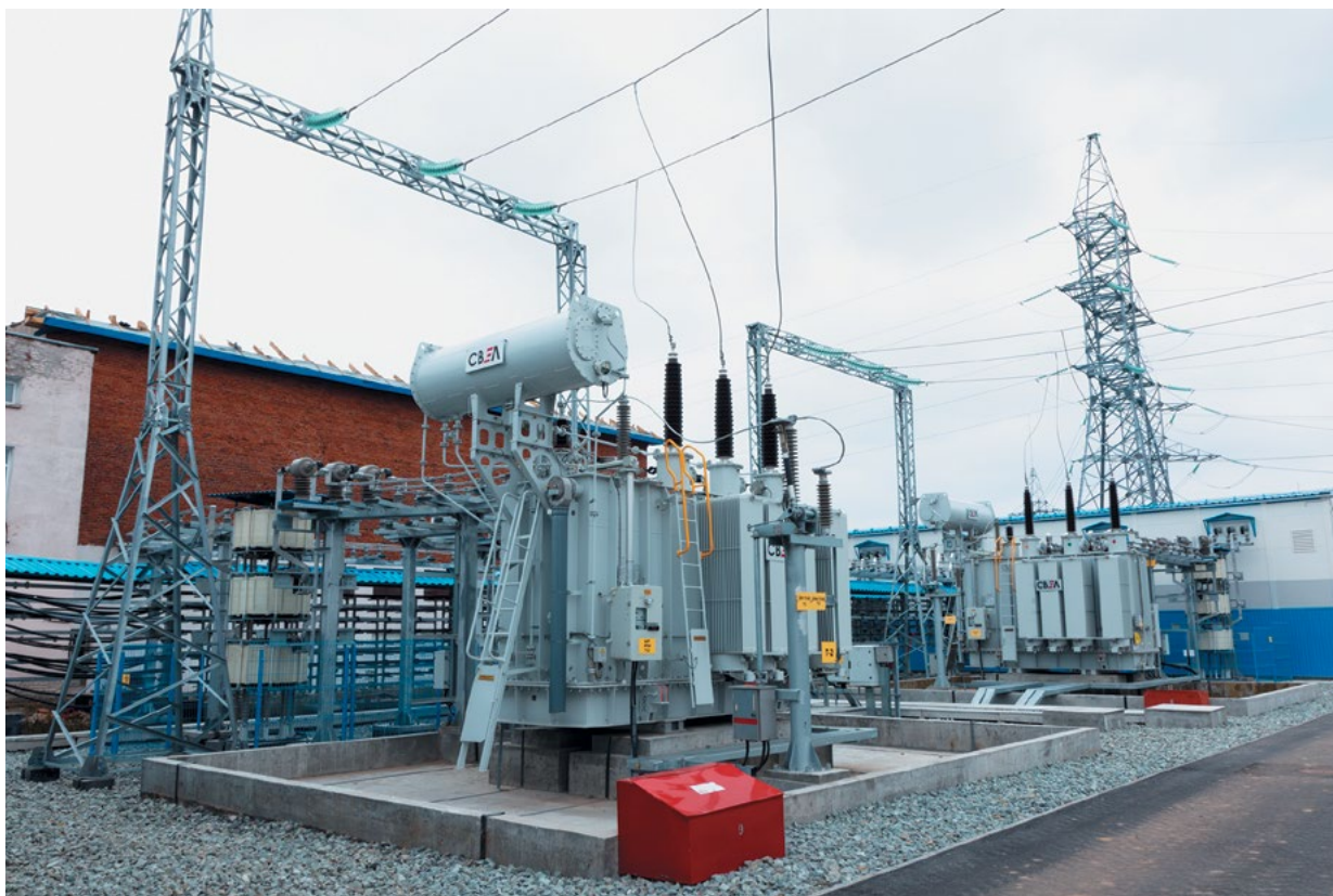
ПС 220 кВ «Зеленодольская», респ. Татарстан, ТРДН-40 000/110 УХЛ1
