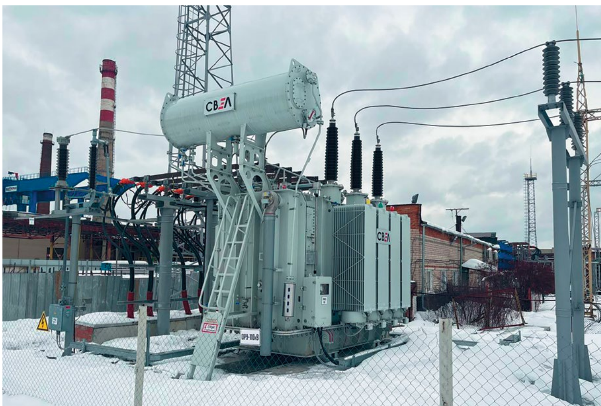
ПС 110 кВ «Электролитная», Челябинская обл., ТРДН-40 000/110 УХЛ1
