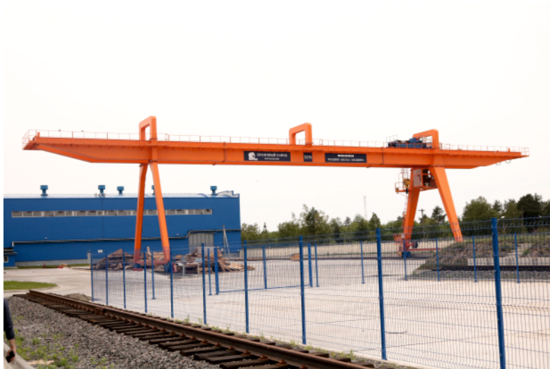
Кран козловой г/п 32/5 тонн общая длина - 54 метра, пролет - 32 метра высота подъема - 10 тонн
